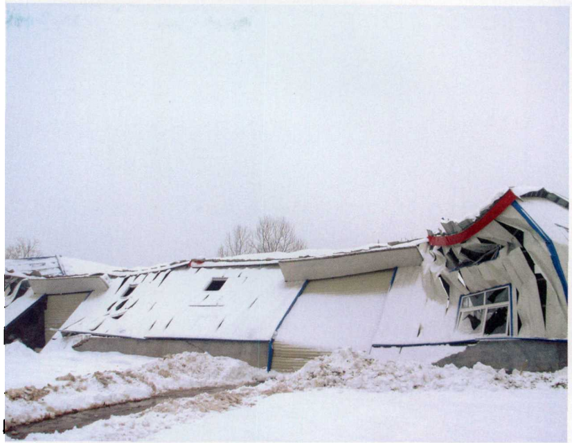
图 4.16.2 2008年1月下旬河南省信阳市房屋被积雪压塌 (信阳市气象局提供)
