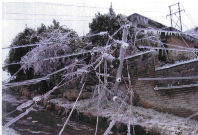
图 4.24.2 2005年2月中旬贵州省万山特区发生凝冻灾害 高压线被积冰压断(杨碧桃摄)
