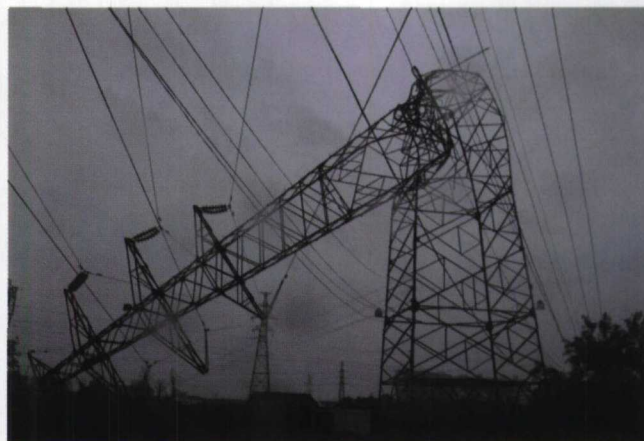
图4.10.3 2005年8月6日受台风“麦莎”影响，江苏省无锡市一座110千伏高压铁塔倒塌(江苏省气象局提供)
