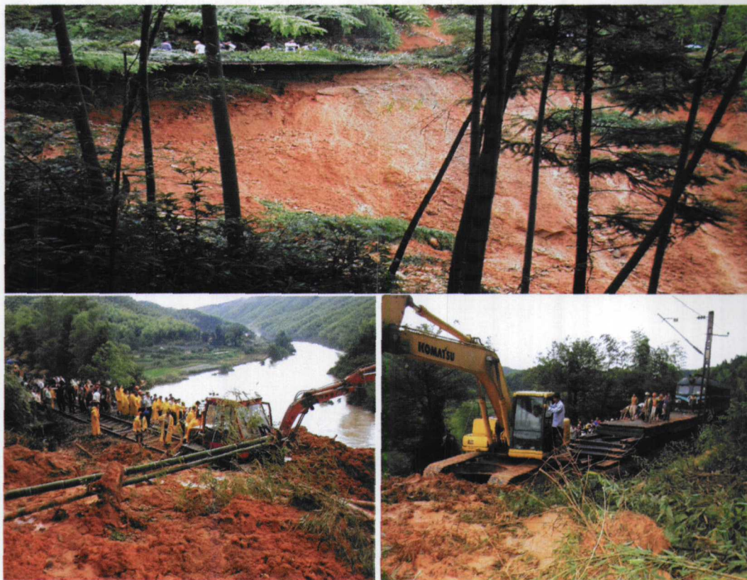
图4.14.1 2005年6月19日江西省资溪县境内公路出现坍塌造成铁路中断(张良林摄)
